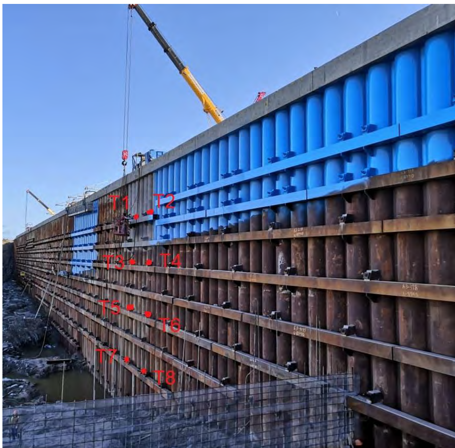
Рис. 4. Установка сети акселерометров
